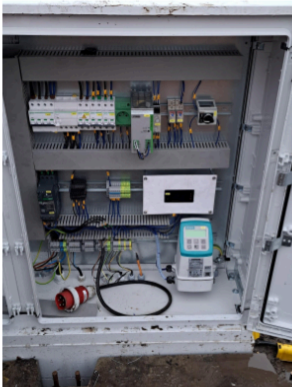
Binnenkant van de bedieningskast.
