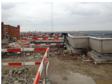
Zaterdag: sinds 7 uur zijn zware sloopwerken op het dak van de werftoren bezig.
